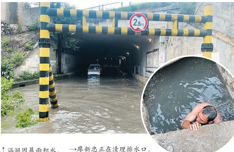
↑涵洞因暴雨积水。 →廖新忠正在清理排水口。
