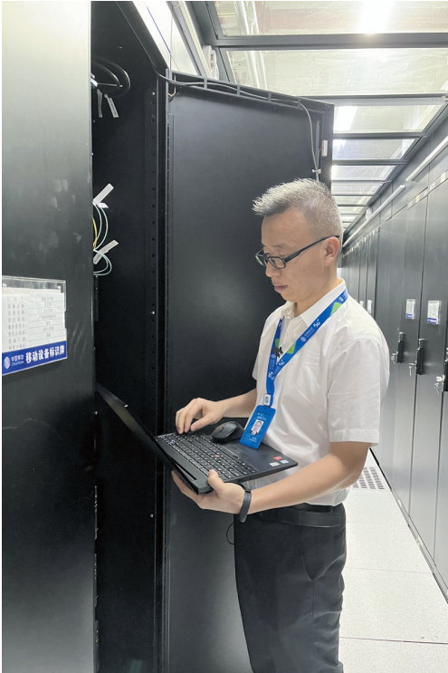
范清栋正在机房内工作。
