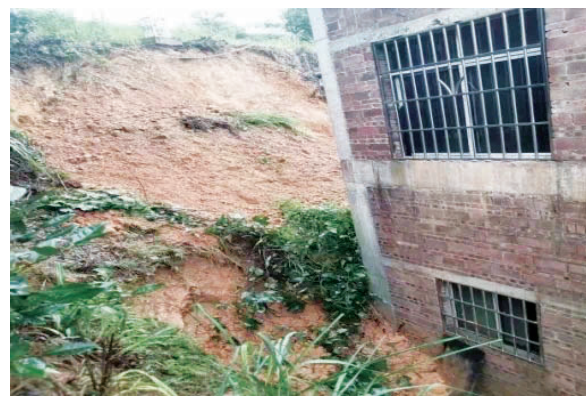
三江侗族自治县良口乡产口村高贵屯发生的崩塌地质灾害，屋内人员及时撤离未受影响。
