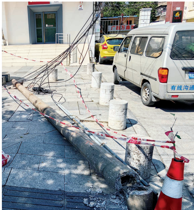
通信线杆横在路面上。
