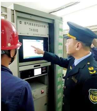
执法人员对柳钢1#360烧结机废气排放口污染源自动监控数据进行检查。
