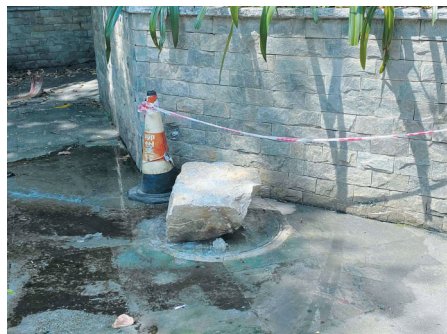
污水不断从井盖冒出。
