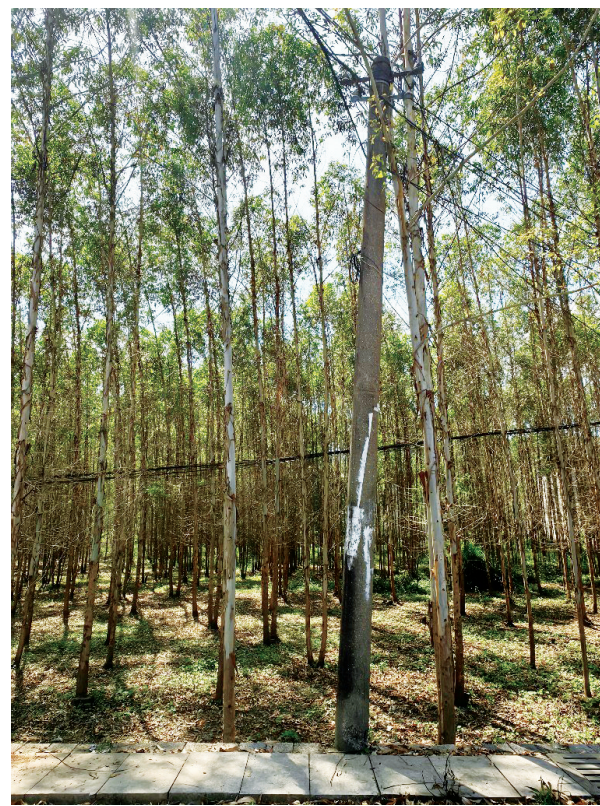
线杆已发生明显倾斜。
