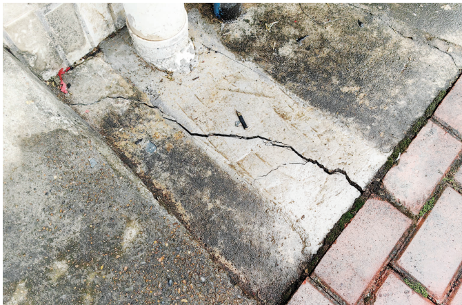
因施工出现的地面裂痕。
