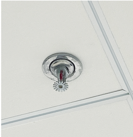
潭中东路一写字楼里的自动喷淋系统。
