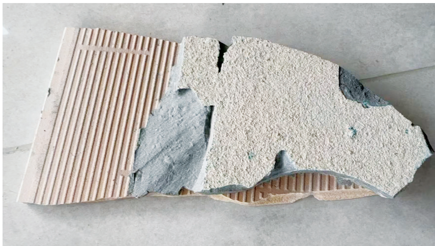
拆下的瓷砖碎块上黏贴着一层水泥砂浆。
