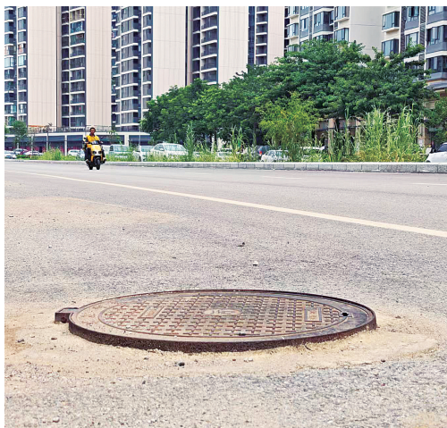
井盖凸出路面。
