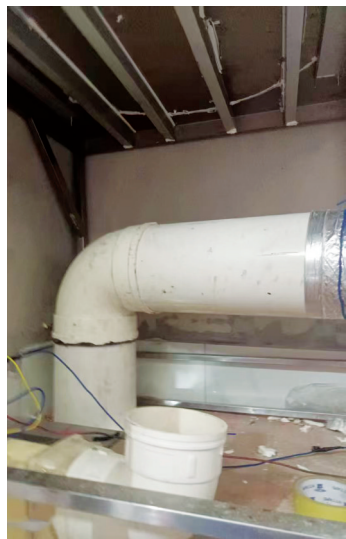
商家将烟管接入下水道。
