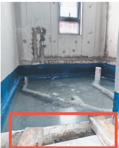
楼上装修工人做闭水试验时，水从挡板位置渗漏。
